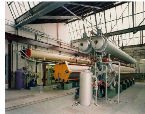
Lurgi Pressure Electrolyse (760 Nm 3 /h; 32 bar) *bezogen auf HHV: 1,48 V
